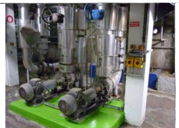
Chaufferie Malakoff Nantes
