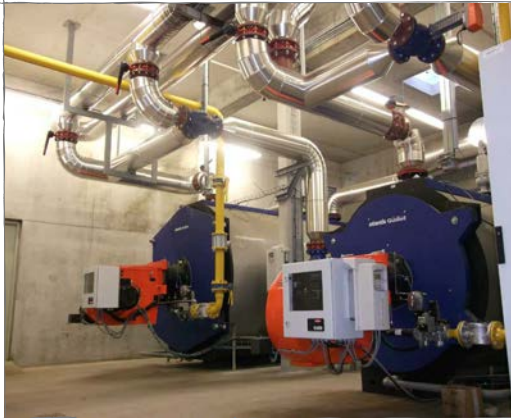
Chaufferie CHANTRERIE - Nantes
